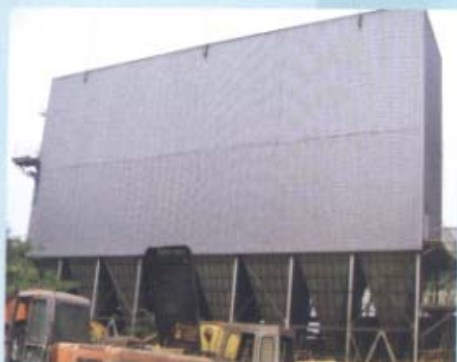
Gambar 4. Contoh peralatan pengendalian pencemaran udara jenis bag house filter terpasang pada Industri Peleburan Logam
