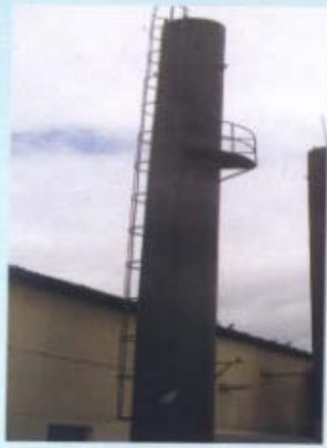
Gambar 9. Contoh cerobong emisi udara yang sudah dilengkapi dengan sarana Pendukung sampling seperti : lubang sampling, lantai kerja (platform), tangga, pagar pengaman dan sumber listrik
