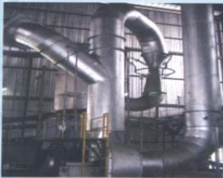
Gambar 3. Contoh peralatan pengendalian pencemaran udara jenis wet scrubber yang terpasang pada boiler bahan bakar batubara
